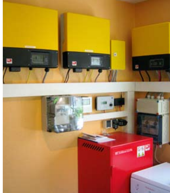
Dies sind der Batteriespeicher und die Wechselrichter zu einer PV-Anlage, die der Fachbetrieb Sonnen-Energie-Zentrum in Ostfriesland gebaut hat.
